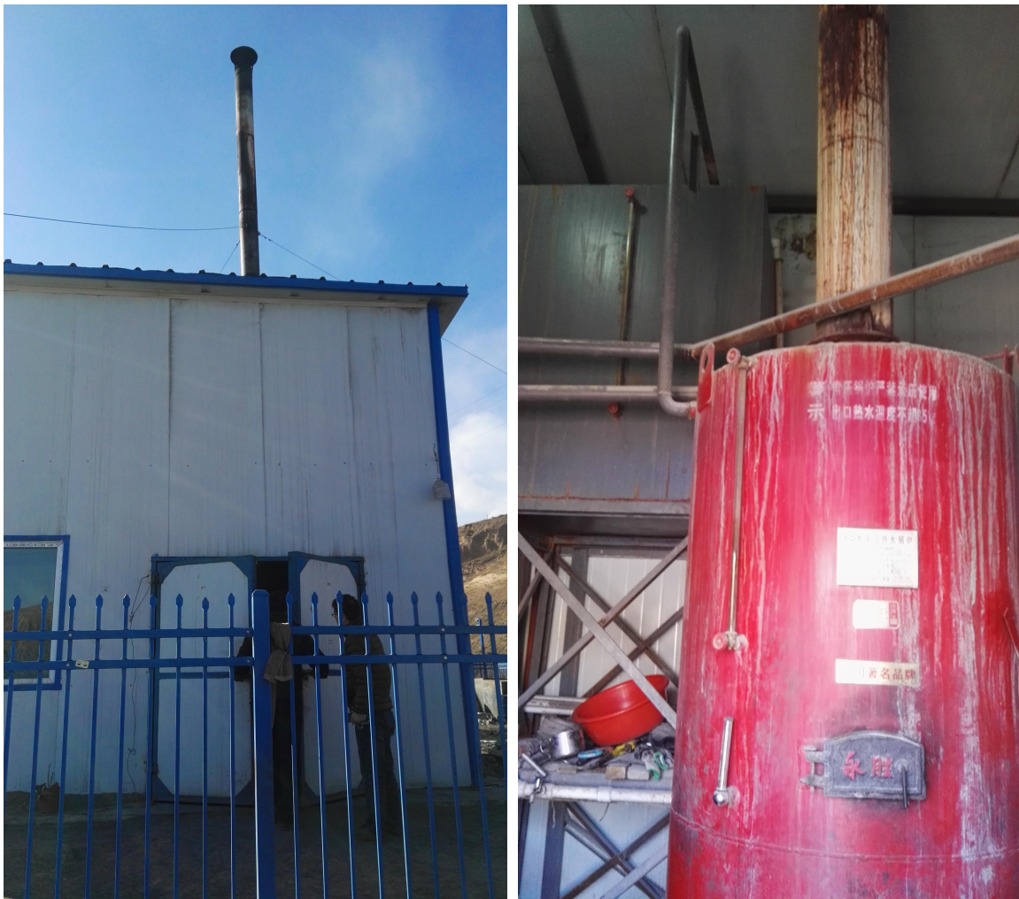
临时锅炉房情况
