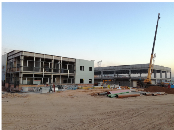
矿井水处理车间
