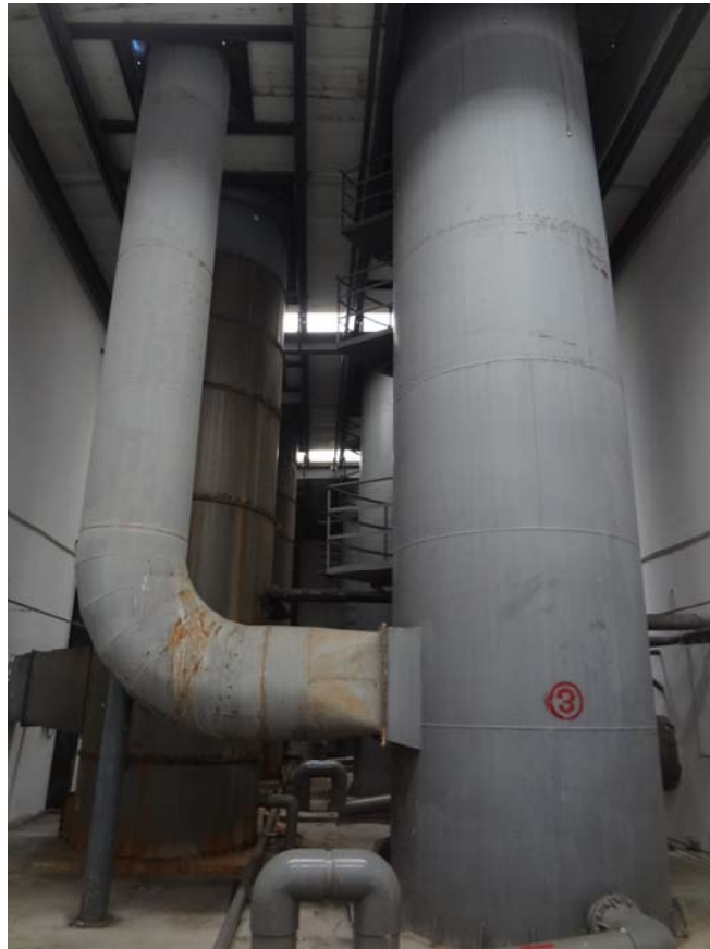
图 6.5-1 锅炉房脱硫除尘器
