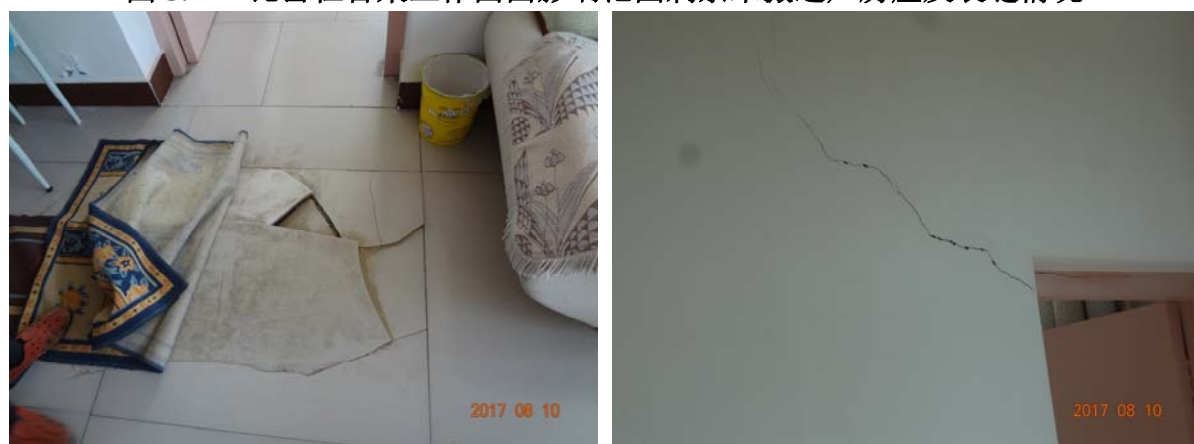
图 3.2-3 陈家村首采工作面影响范围剩余未搬迁户房屋裂缝情况
