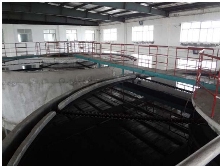
图 8.4-1 矿井水处理站（常规处理部分）
