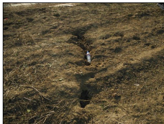
照片 6 L6 地面塌陷
