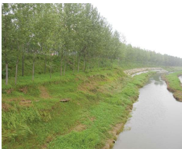
图 5 小洪河小王庄处险工护坡
