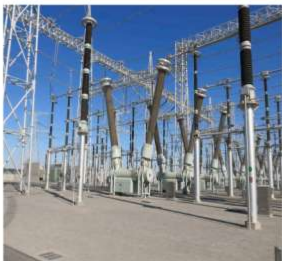
750kV 交流设备区
