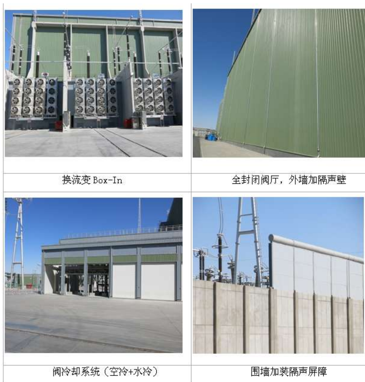
图 3.1-5 天山换流站主要噪声治理措施
