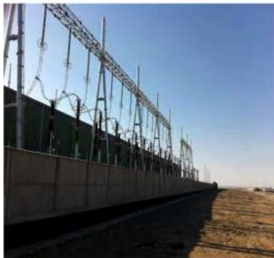
换流站 500kV 进线端
