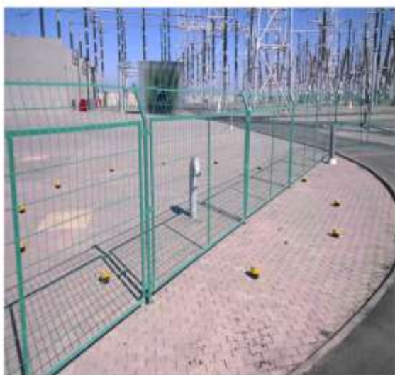
750kV高抗事故油池
