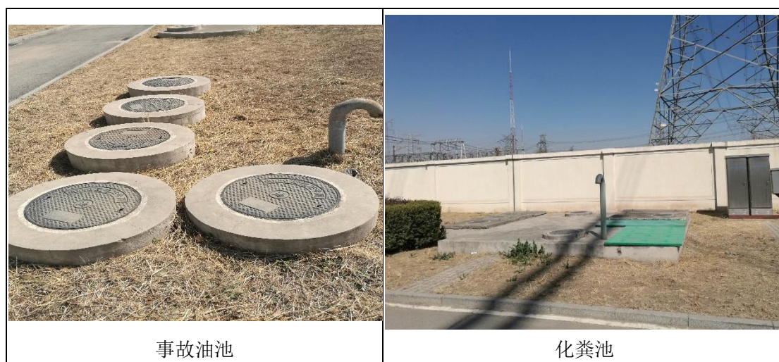
图 3.5-1 房山 500kV 变电站前期环保设施
