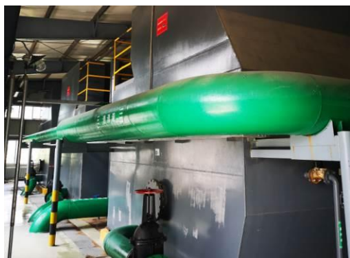
图 3.1-3 一体化水处理设备
