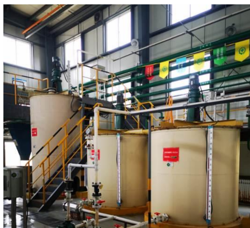
图 3.1-6 淋洗液配制槽及搅拌沉淀槽
