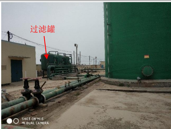
过滤罐（角四接转站）
