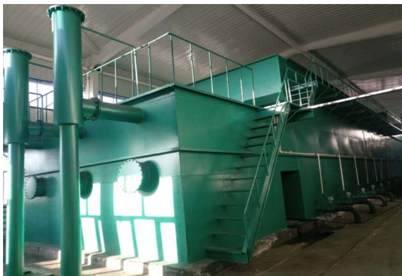
矿井水处理站图片
