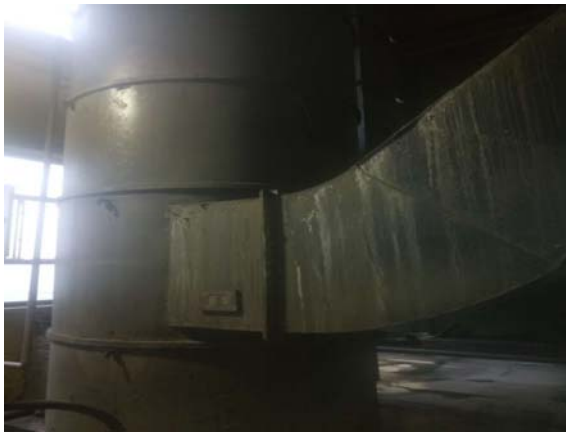
水膜脱硫除尘器
