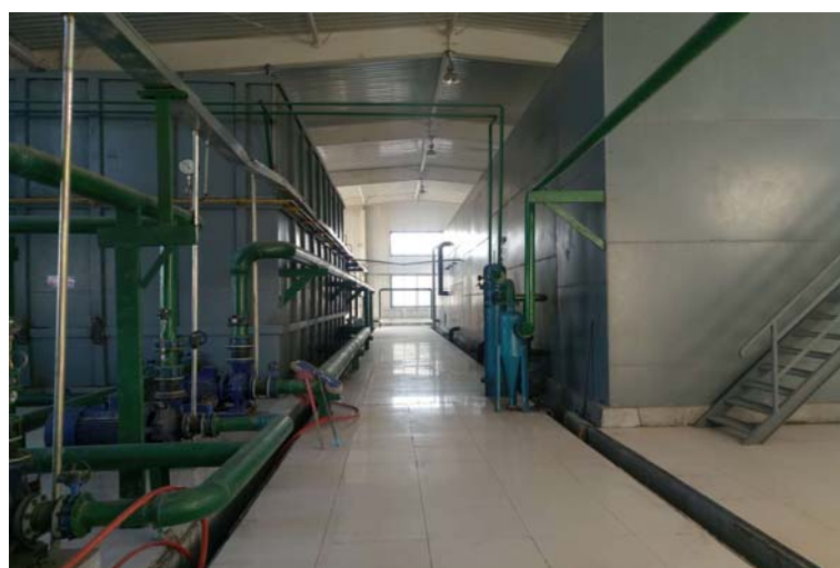
生活污水处理站图片
