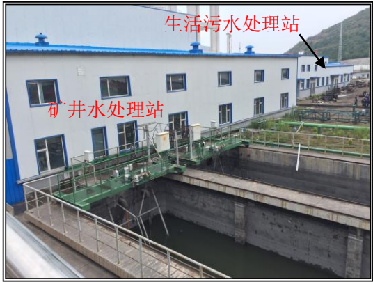
矿井水处理站预沉调节池
