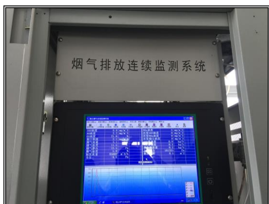
锅炉尾气连续监测系统
