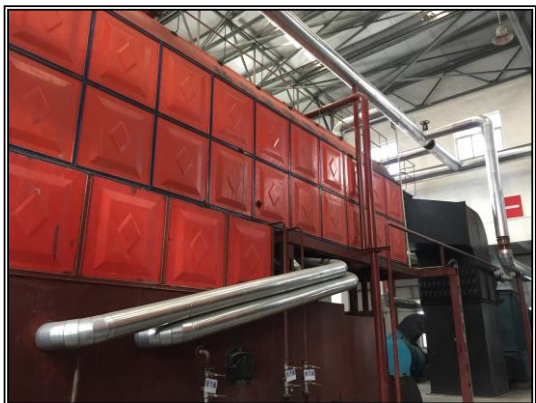
锅炉房内蒸汽锅炉
