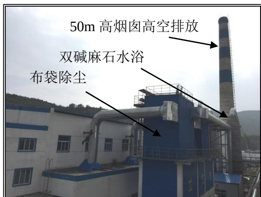
临时锅炉尾气处理设施
