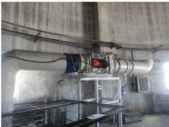
原煤仓下方湿式除尘风机
