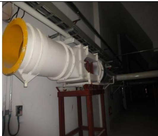
受煤坑除尘器
