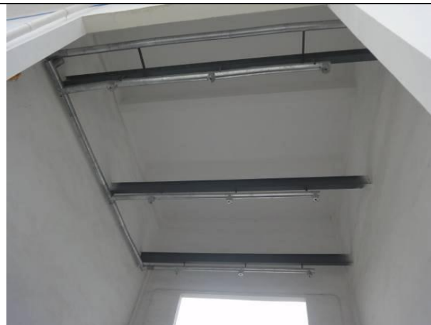
受煤坑上方洒水喷头
