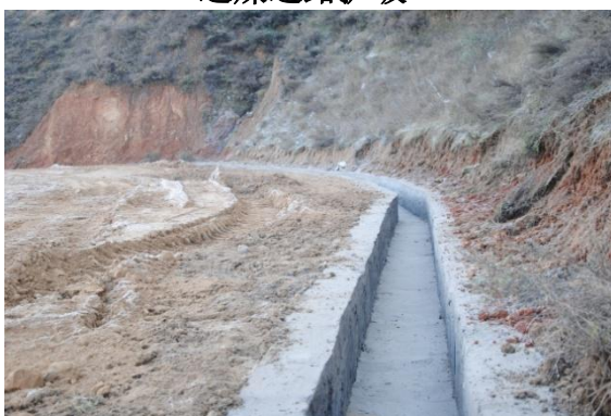
矸石场排水沟
