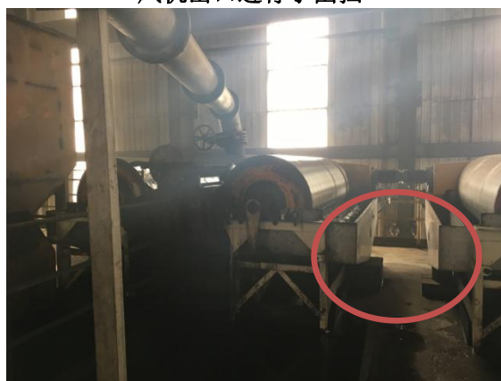
选煤厂设备采用减震基础
