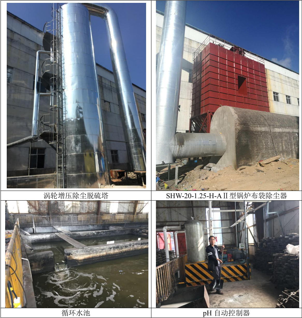
图 8-3-3 锅炉房烟气处理措施
