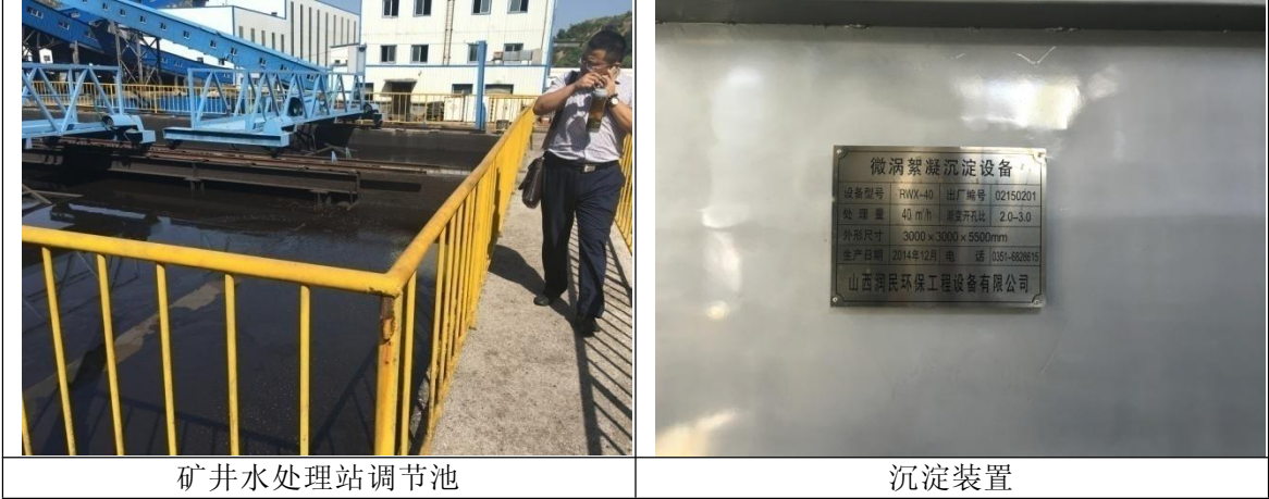
图 7-3-2 矿井水处理站主要设备
