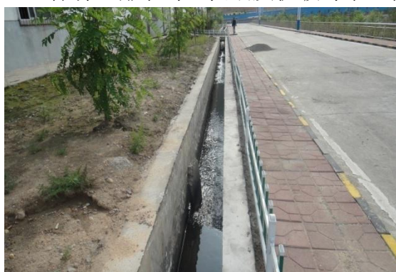
工业场地排水沟
