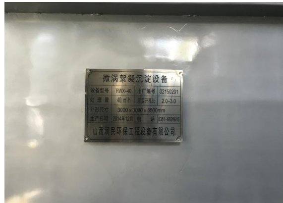
矿井水处理站沉淀装置
