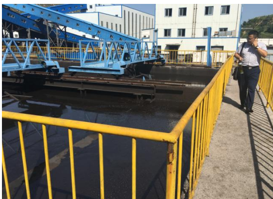
矿井水处理站调节池
