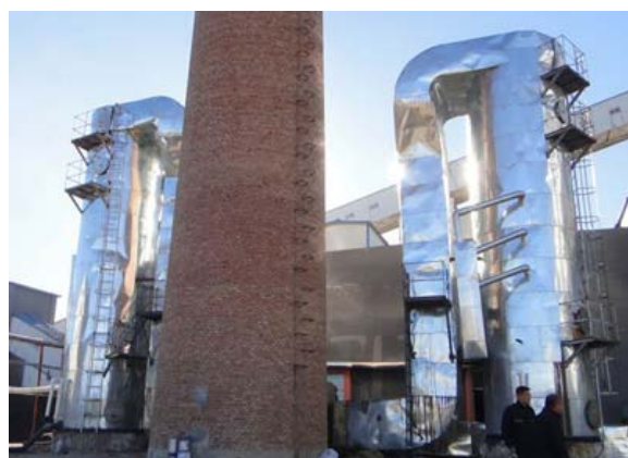
双碱法脱硫塔（2 台）
