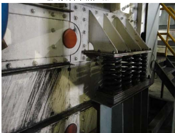
震动设备安装减震弹簧
