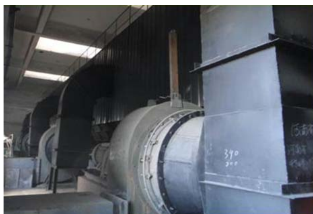
锅炉房布袋除尘器（共 4 台）
