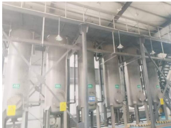
一工区现有离子交换塔
