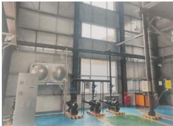
一工区现有原水泵
