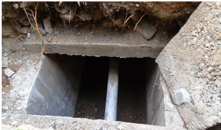
图 3.2-1 已打开盖板的特排管线
