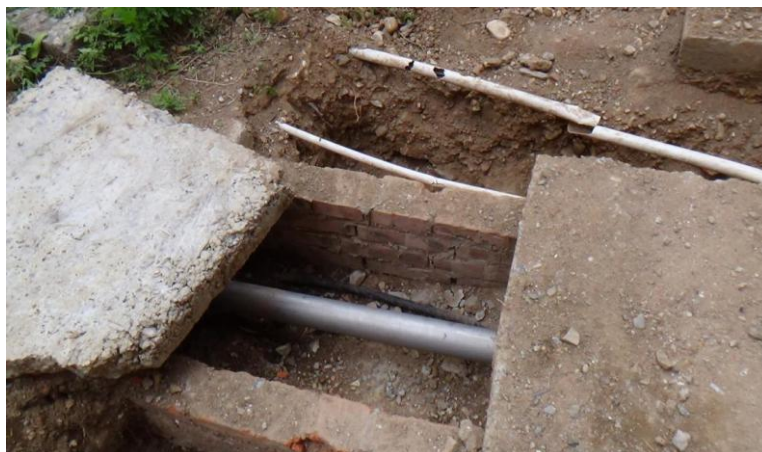
图 3.2-2 已打开盖板的特排管线
