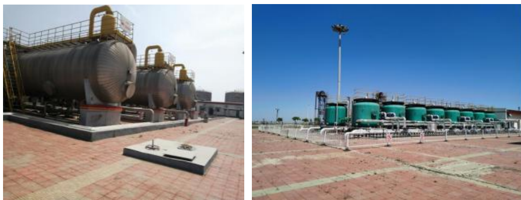
图 2.2-2 NP1-1D 人工岛原油分离及生产水处理区现场照片
