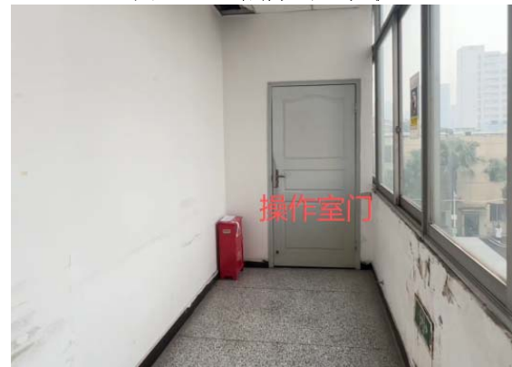
图 8-12 三层走廊现状
