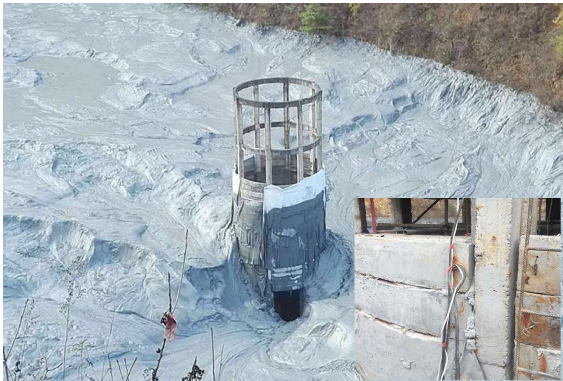
图 2 2#排水井泄漏位置及拱板安装缺陷图
