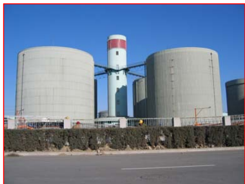
图 3-2 污水处理厂柱形消化池
