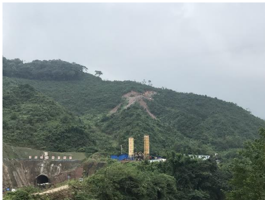
导流洞出口混凝土拌和系统
