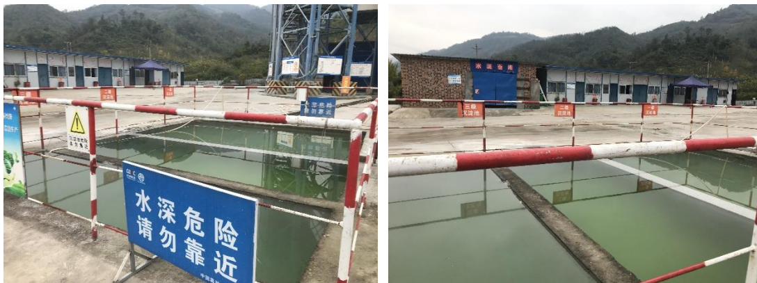
导流洞进口混凝土拌和系统三级沉淀池
