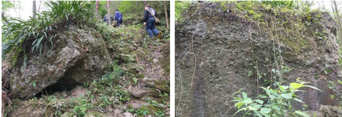
老鹰岩料场 2008 年地震垮塌至坡脚岩石（砾岩）
