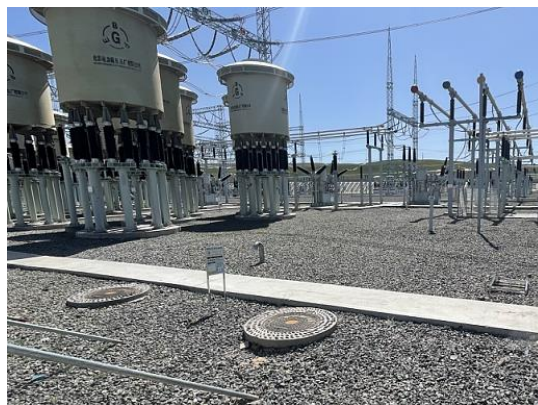
现有工程主变事故油池
