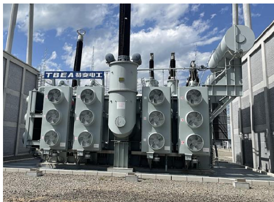
现有工程主变
