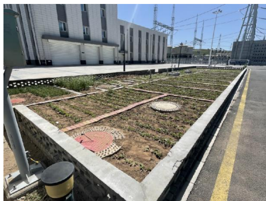
现有工程污水处理设施
