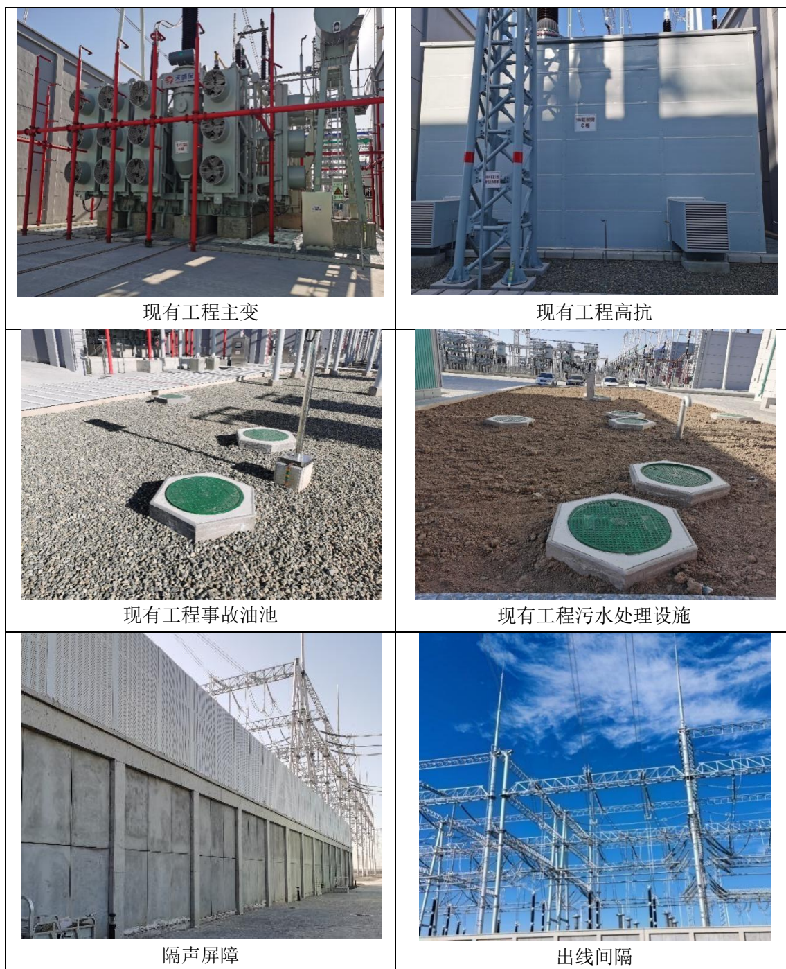
图 3.1-4 张北变电站现有工程
