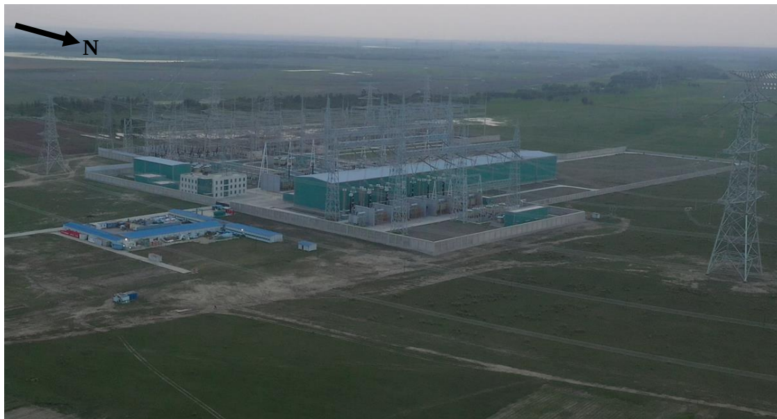
图 4.2-1 张北变电站现状
