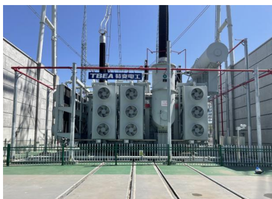
现有工程 1 号主变
