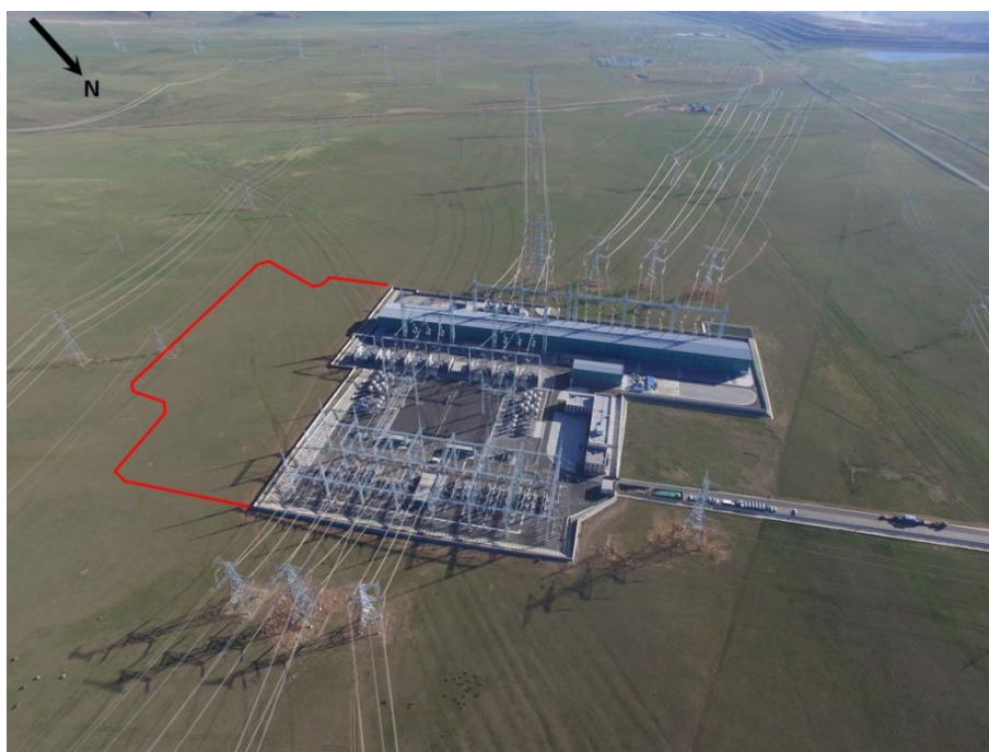
图 4.2-2 胜利变电站现状
