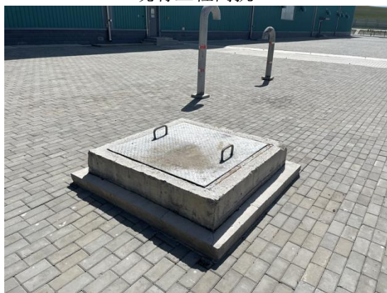
现有工程高抗事故油池
