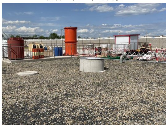
现有工程事故油池
