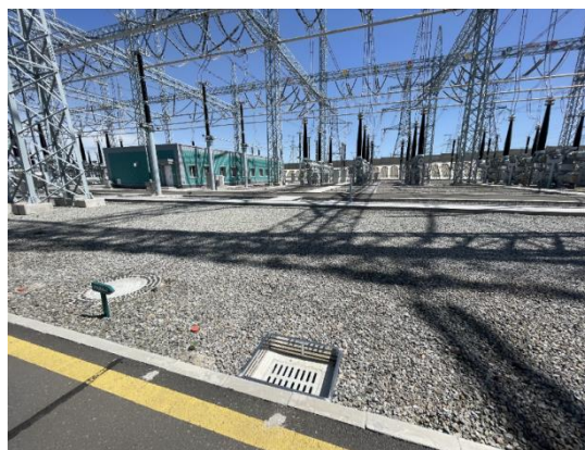
现有工程站用变事故油池
