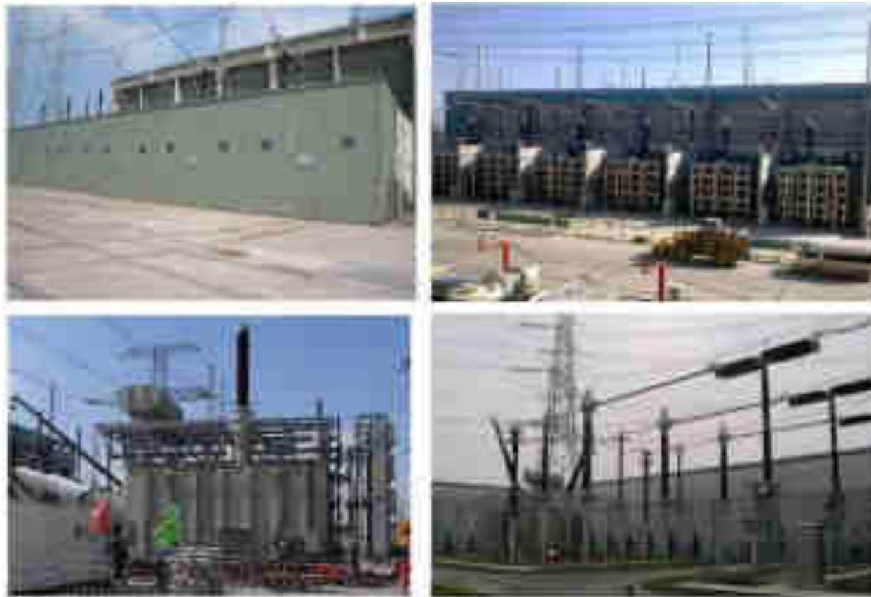
图 3-6 特高压换流站典型噪声控制措施实例
