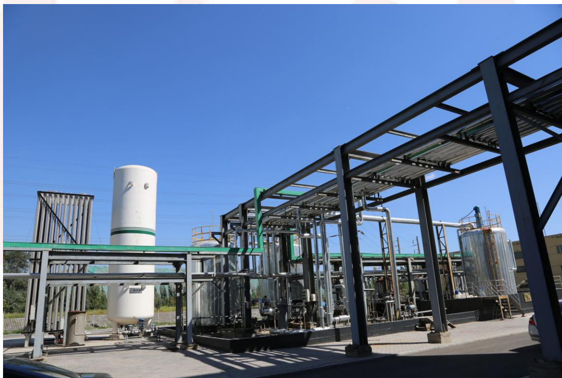
包钢钢渣碳化法生产线
