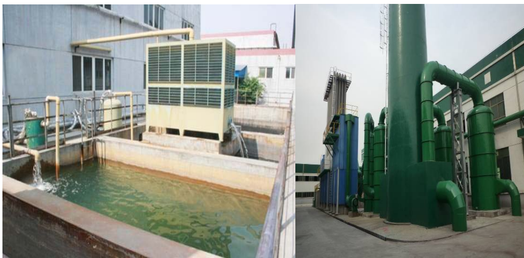
图 16 废水及废气处理装置
